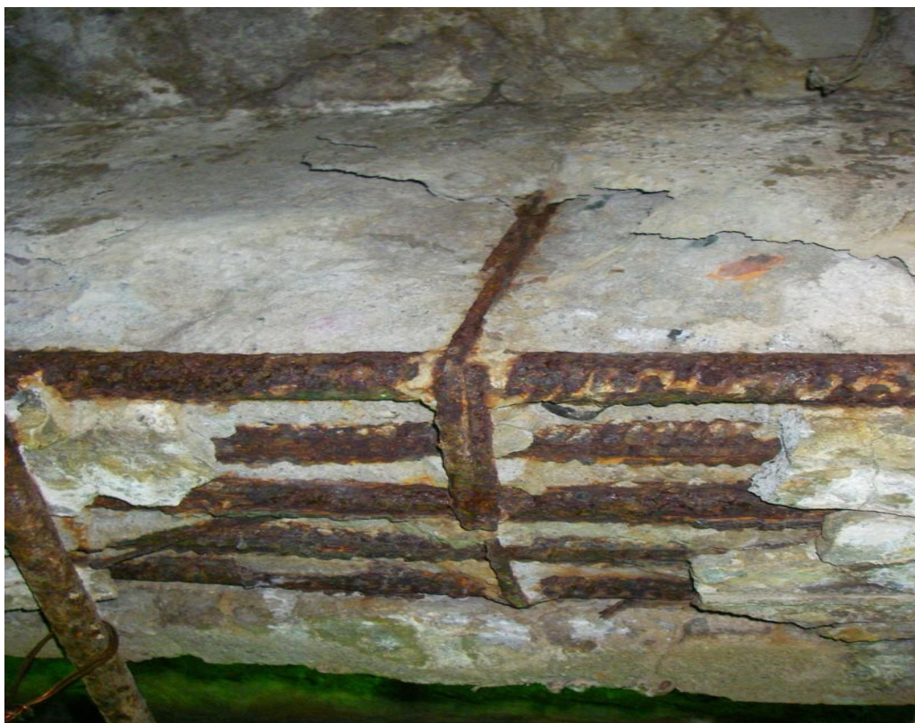
2-rasm. Ko'prik konstruksiyasining shikastlangan qismi
